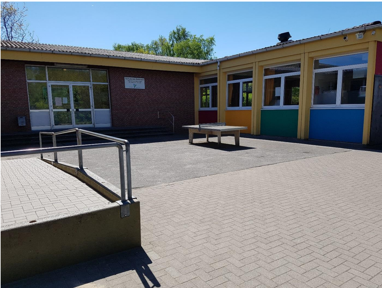
Bild 4: Blick vom Haupteingang zur Mensa – Innenhof (Betonpflaster, schadhafte Bitumendecke)
